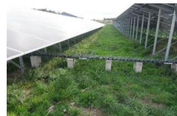
Câbles hors sol – source : LUXEL
